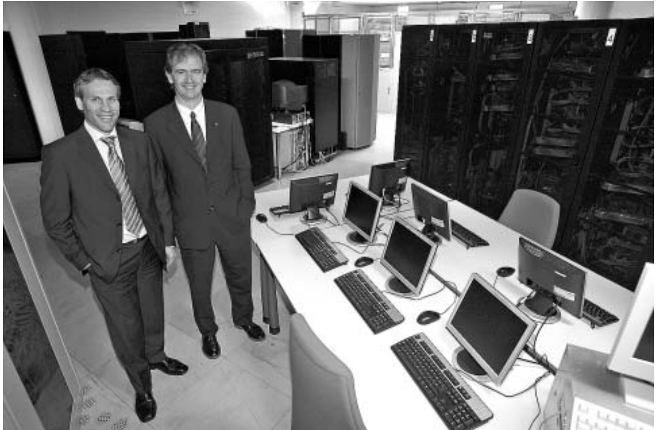
IT-Auslagerung ohne Probleme: Hans Nagel (links) und Eduard Gasser sind erleichtert, dass das neue Rechenzentrum der T-Systems einwandfrei funktioniert. Bild Nicola Pitaro
